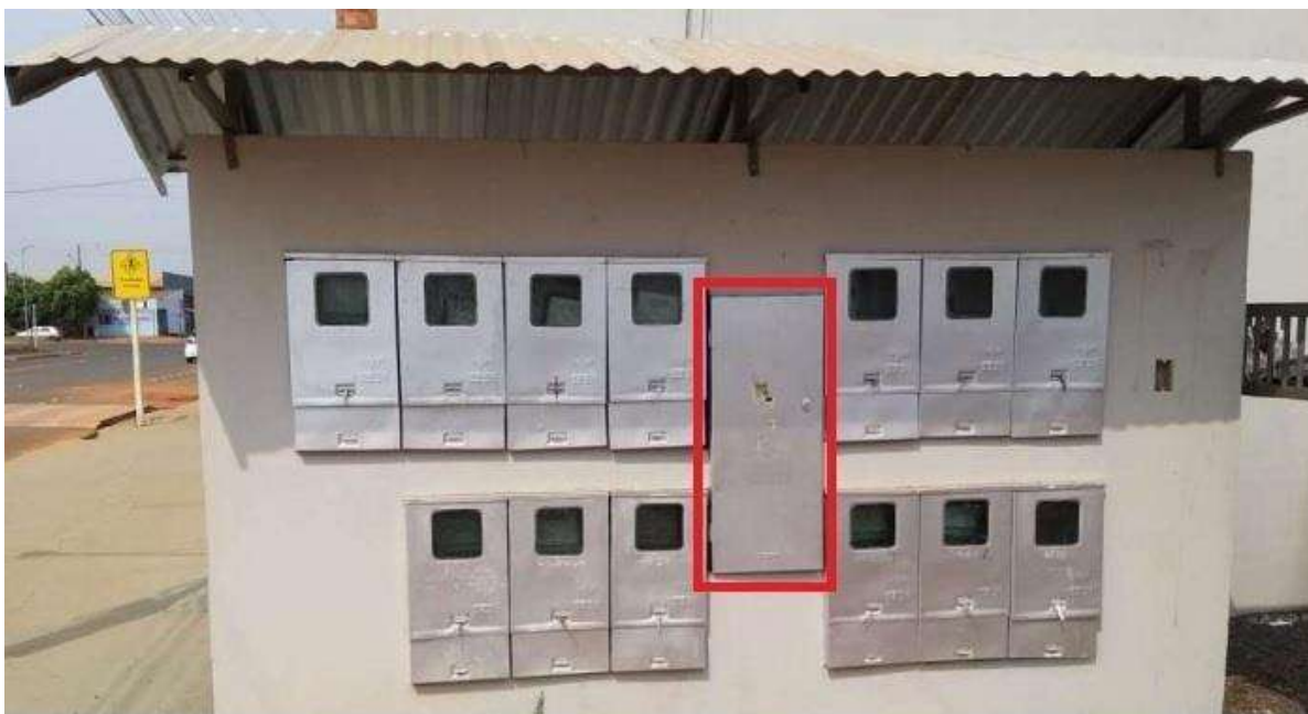
Disjuntor Geral da Medição Agrupada fica Dentro da Caixa Circula
